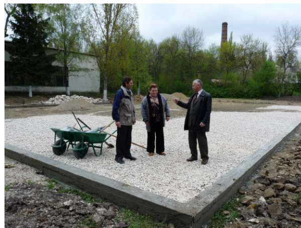
Der Präsident des Bezirkes Singerei, Herr Vasile Doga (der erste vom rechts) überwacht die Bauarbeiten
