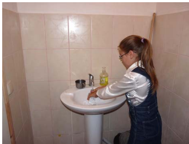
Endlich neue Sanitäranlagen
